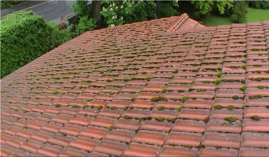
Bild 1: Dach mit Moos und Algen
