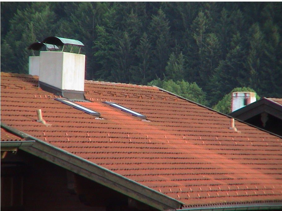
Bild 2: Wasserlauf unter Kamineinblechung aus Kupfer sauber
